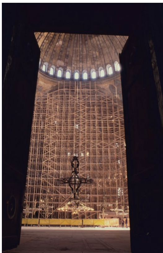
Fig.18 改修中のアヤソフィア寺内部 イスタンブール 筆者撮影 1989年
